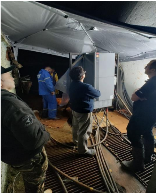
Parametrização, configuração de automação em inversor de frequência, comissionamento e start up do sistema de bombeamento. Tanto para instalações com alimentação via gerador ou subestação, a HIGRA foi responsável por colocar o sistema para funcionar, acompanhados da equipe técnica do SEMAE.
