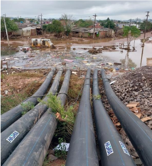
Montagem das linhas de recalque para adução da água drenada dos bairros e passagem de cabos elétricos ao longo do trecho de tubulação para conexão aos painéis elétricos
