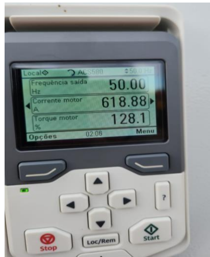
Exemplo de IHM de painel elétrico utilizado para controlar o acionamento dos conjuntos.
