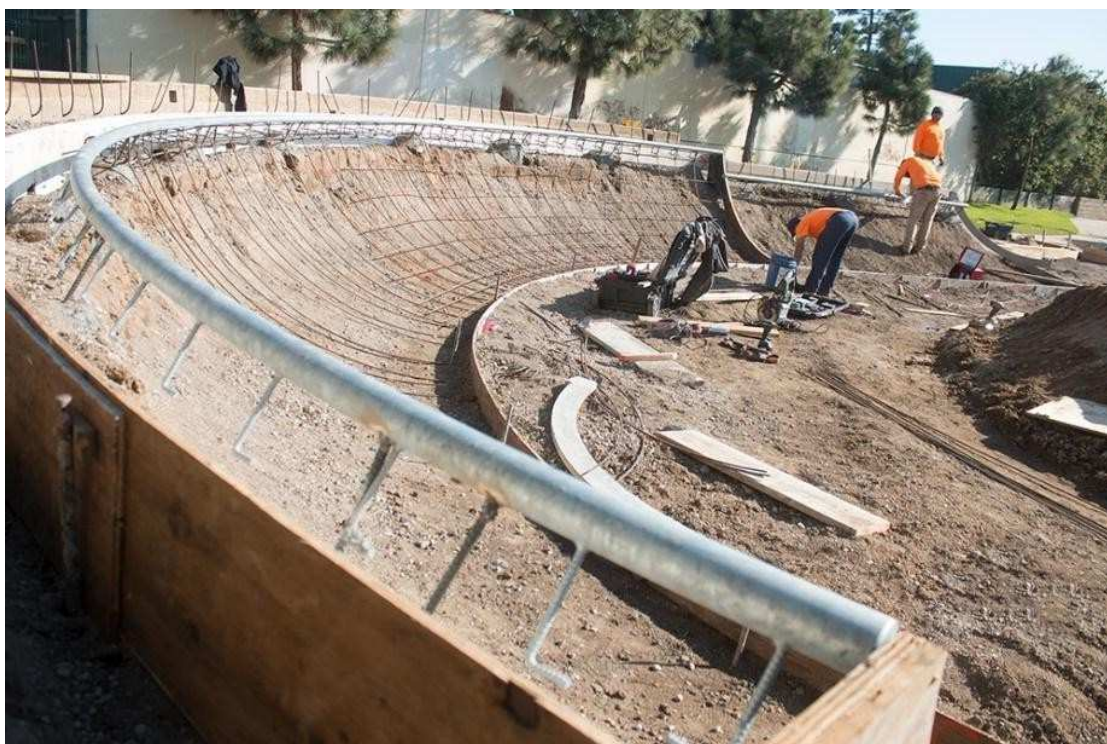
Figura 6 - foto ilustrativa do coping metálico
