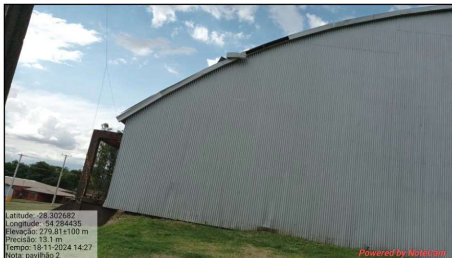
Imagem 7: Condição atual da tabeira/testeira no Pavilhão 2, que será substituída.
