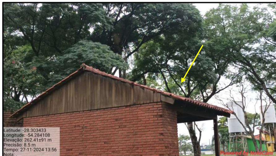
Imagem 8: Detalhe do banheiro e suas condições estruturais.
