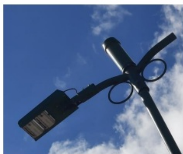
Foto 6: Muitas luminárias estão faltando, gerando pontos escuros
