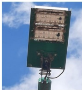
Foto 7: Luminária com mal funcionamento e avançada grau de oxidação.
