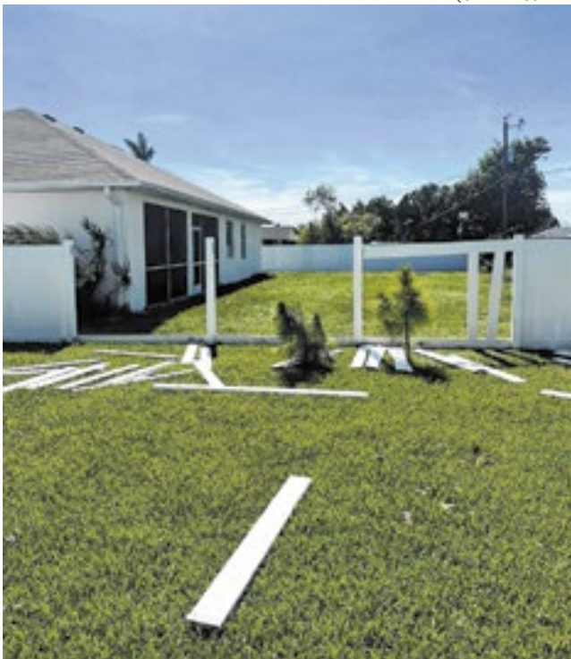
Morador viu estragos na cerca e céu azul após tempestade
