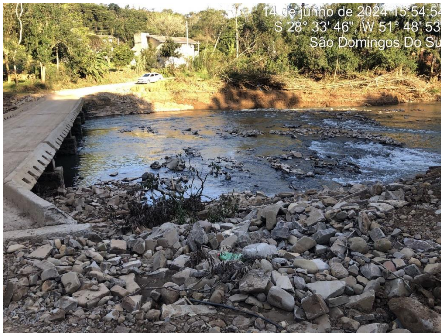
Imagem 04: Ponte com acúmulo de material no entorno;
