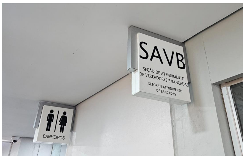
Figura 4: Sinalização existente, que deverá ser mantida. Verificar necessidade de inclusão de novas.
