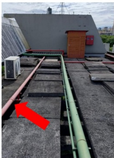
Figura 5 - Rede de canalização de hidrantes em vermelho e casa de bombas ao fundo
