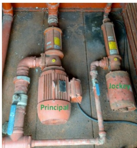
Figura 4 - Conjunto de motobombas
