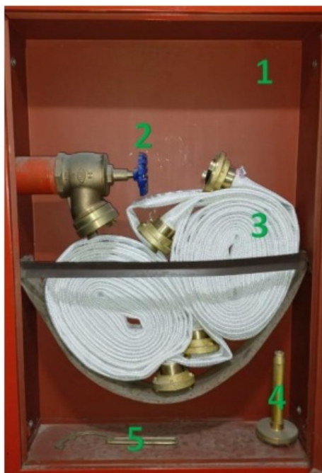
Figura 6 - Abrigo de Incêndio
