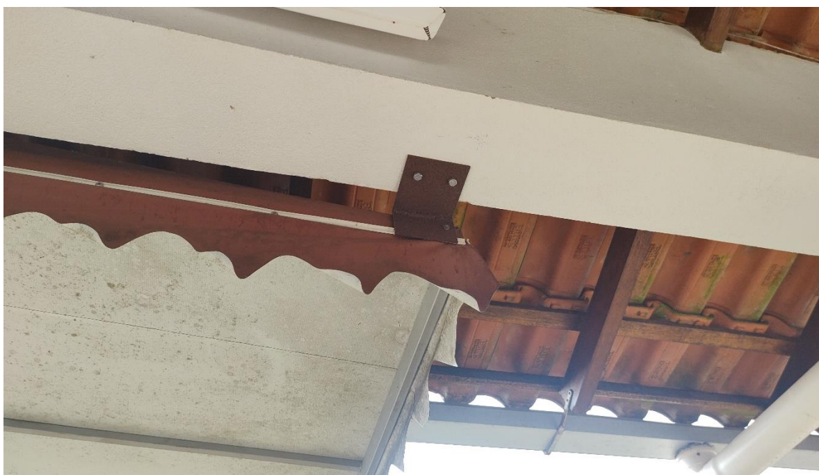
Imagem: pontos da estrutura que iniciaram processo de oxidação.
