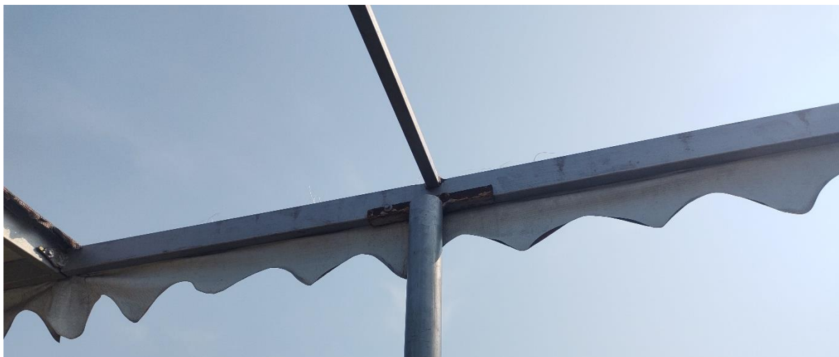
Imagem: pontos da estrutura que iniciaram processo de oxidação
