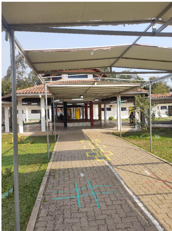
Imagem: toldos a serem removidos e estrutura que deverá ser lixada
