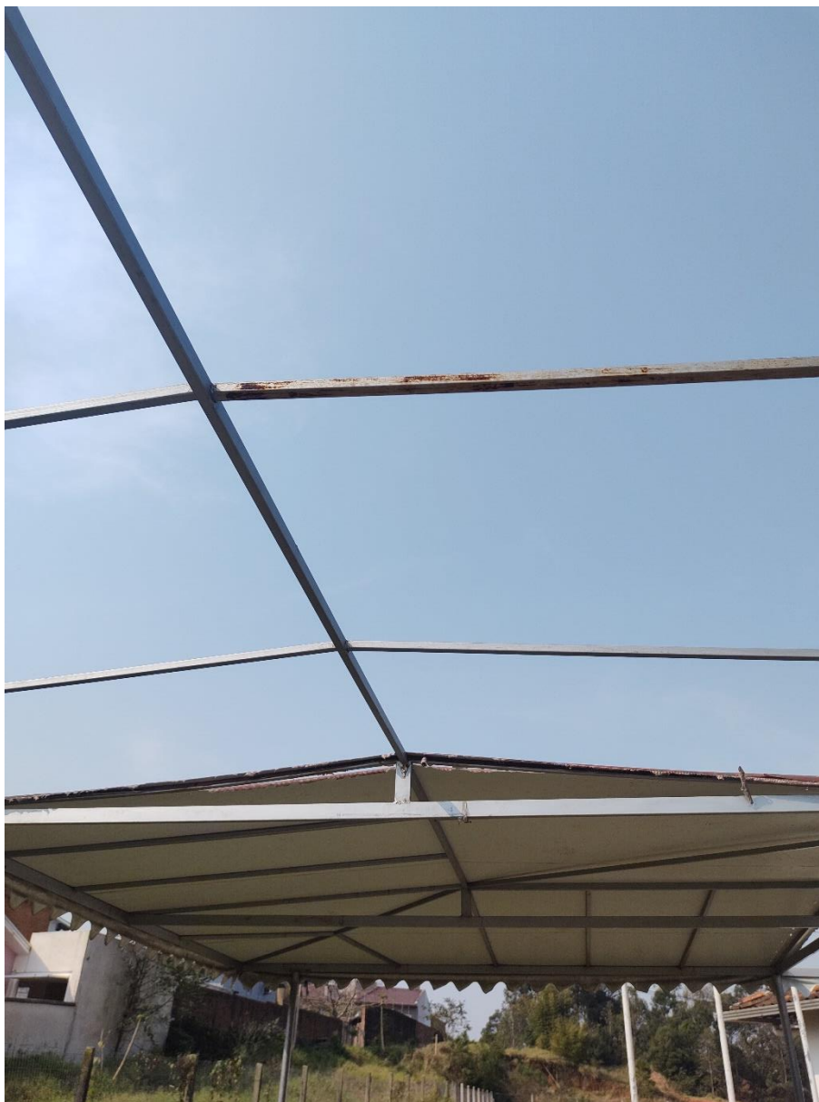
Imagem: pontos da estrutura que iniciaram processo de oxidação
