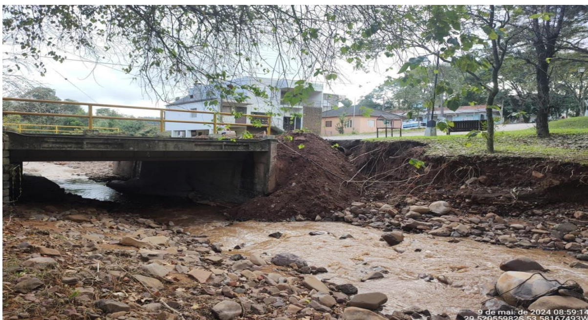
Imagem 2 – talude desestabilizado na ponte da Av. Bento Gonçalves
