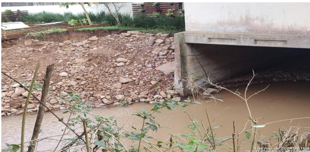
Imagem 1 – talude desestabilizado na Av. Garibaldi
