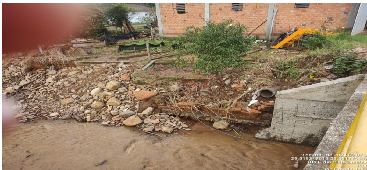
Imagem 4 – talude desestabilizado na ponte da Rua Pinto Bandeira
