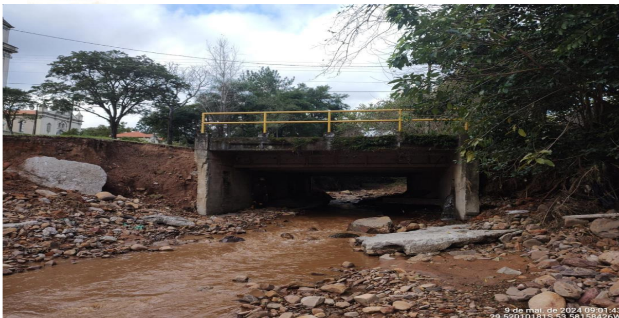
Imagem 3 – outro lado com dois taludes desestabilizados na ponte da Av. Bento Gonçalves
