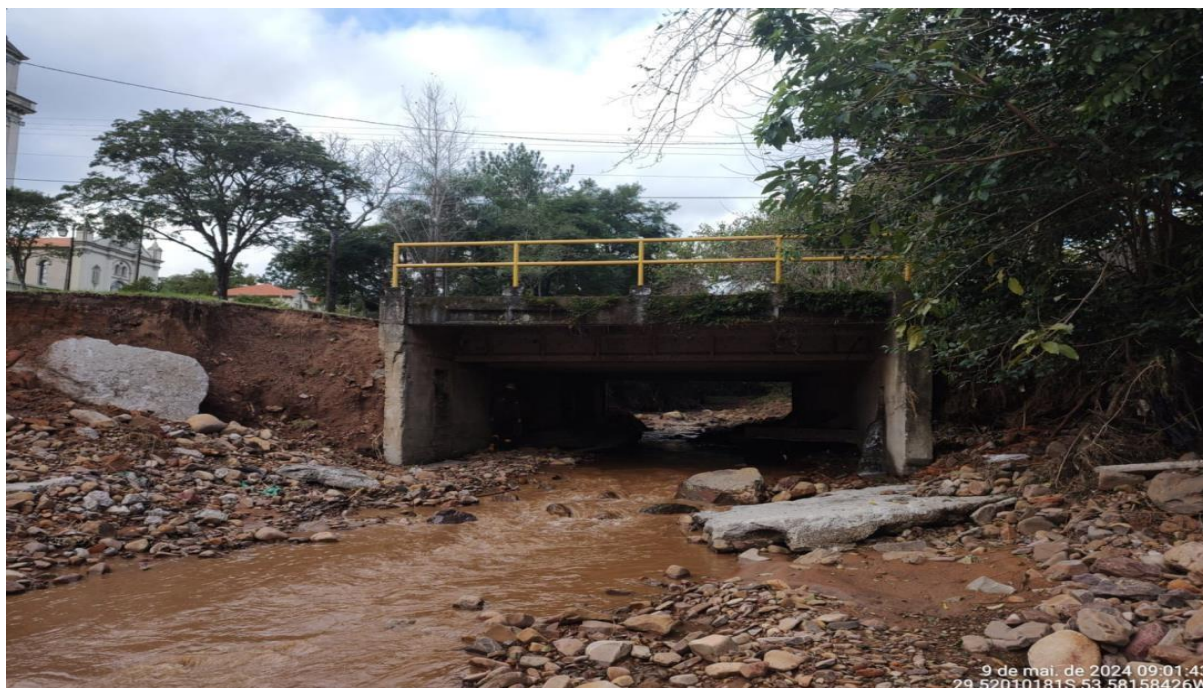
Imagem 3 – outro lado com dois taludes desestabilizados na ponte da Av. Bento Gonçalves
