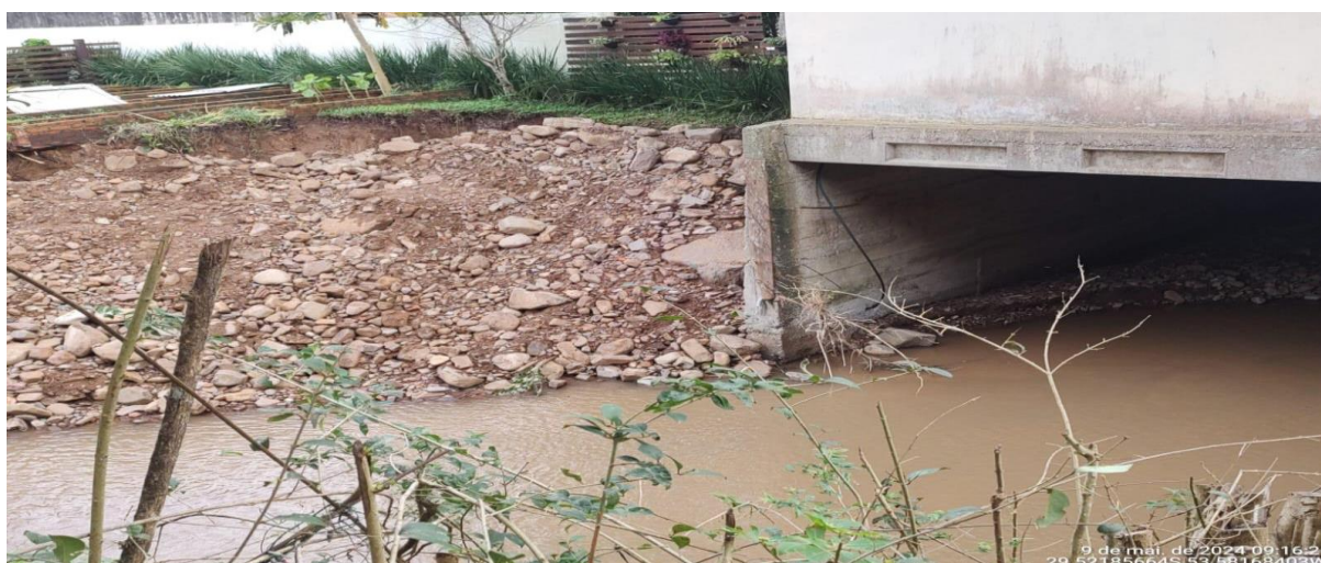
Imagem 1 – talude desestabilizado na Av. Garibaldi
