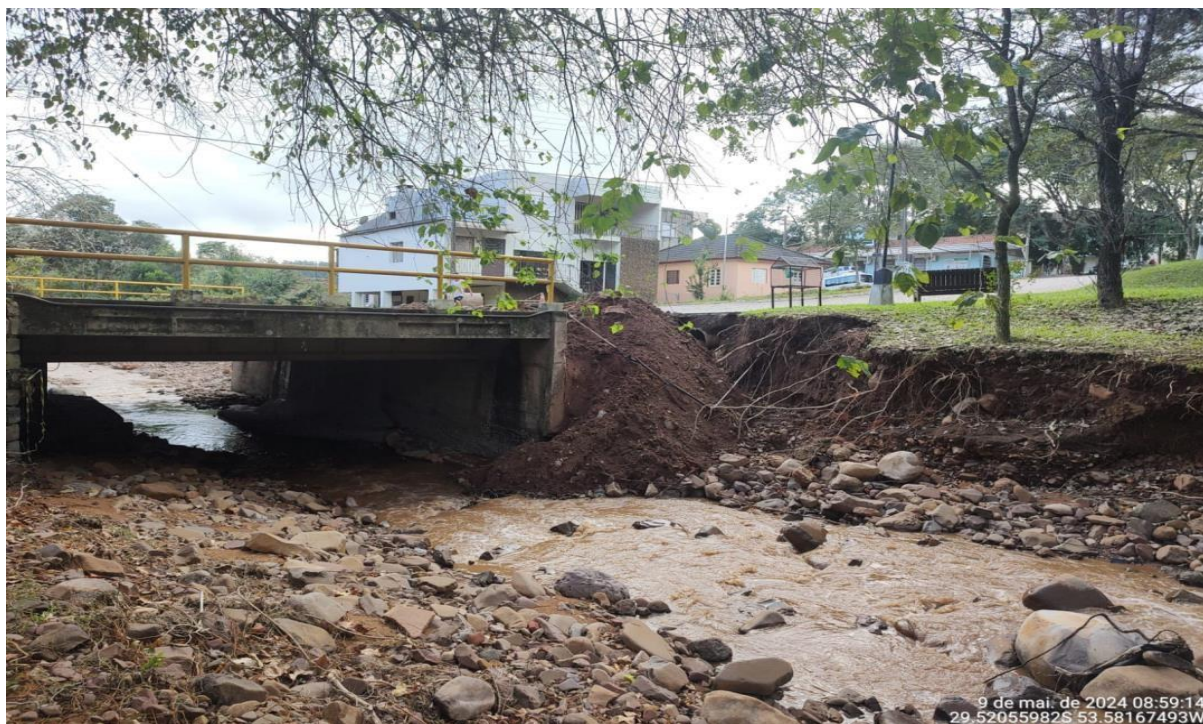
Imagem 2 – talude desestabilizado na ponte da Av. Bento Gonçalves
