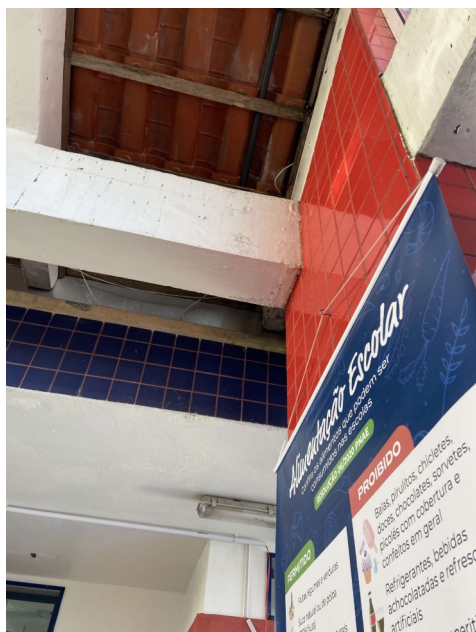
Figura 11: Ripas em estado de degradação.
