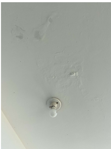
Figura 10: Goteiras e infiltrações no teto da edificação existente .
