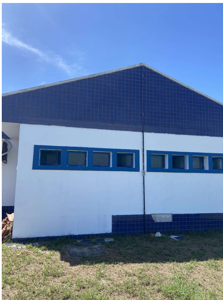
Figura 4: Edificação existente com pastilhas que caíram ao longo dos anos.
