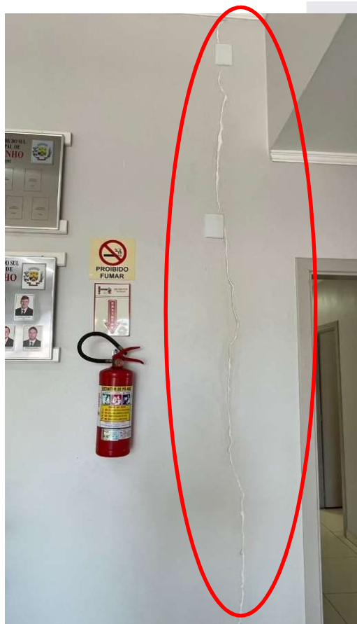
Figura 03 – Trinca na área do Hall de entrada da edificação
