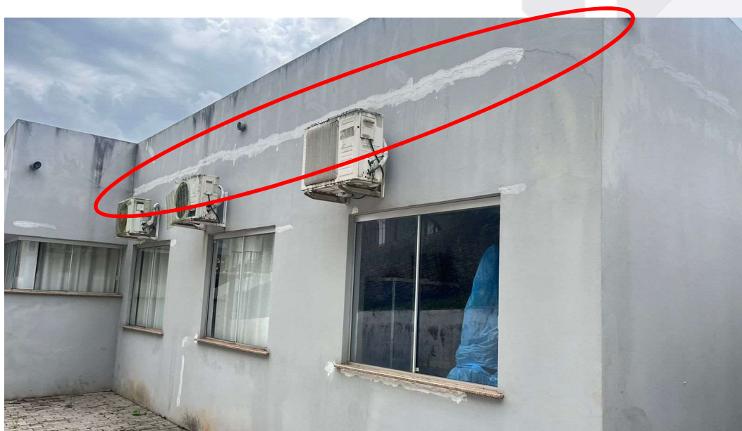
Figura 1 – Trinca na interface laje-platibanda
