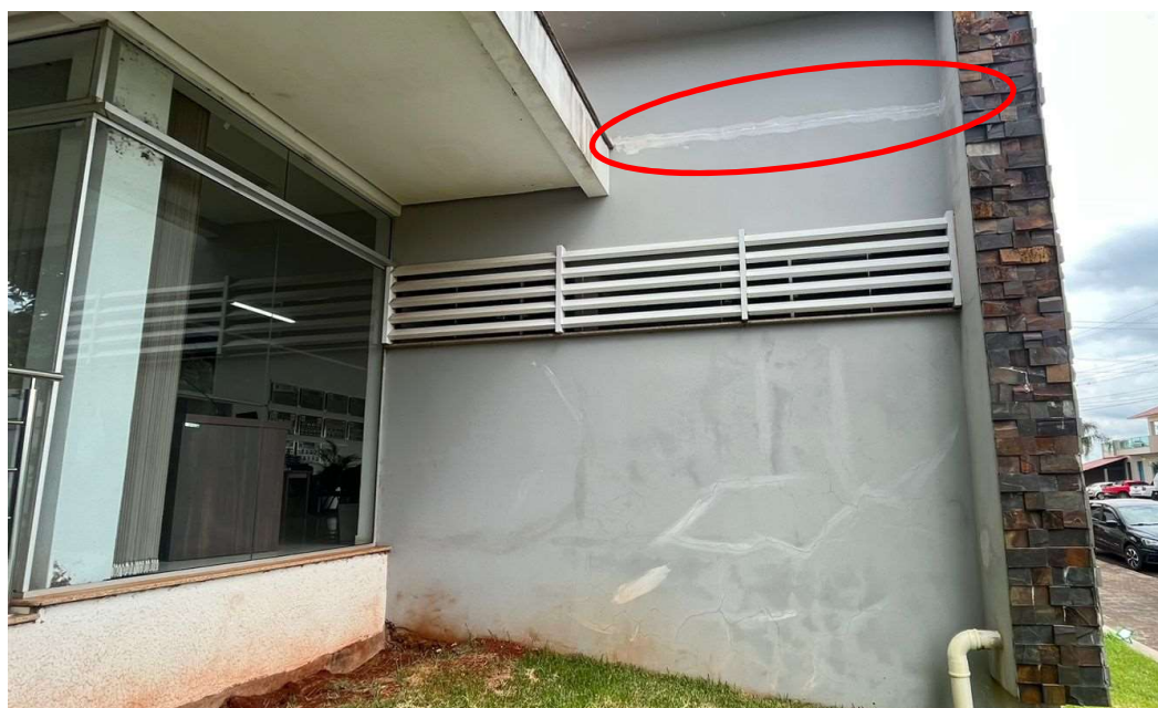
Figura 2 – Trinca na interface laje-platibanda
