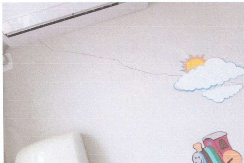
Figura 10: Parede Interna Fissurada
