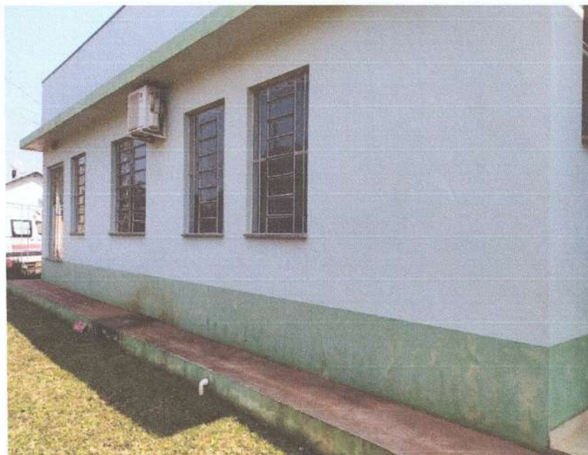
Figura 12: Parede Externa com Pintura Deteriorada
