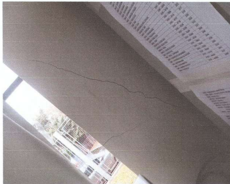
Figura 11: Parede Interna Fissurada
