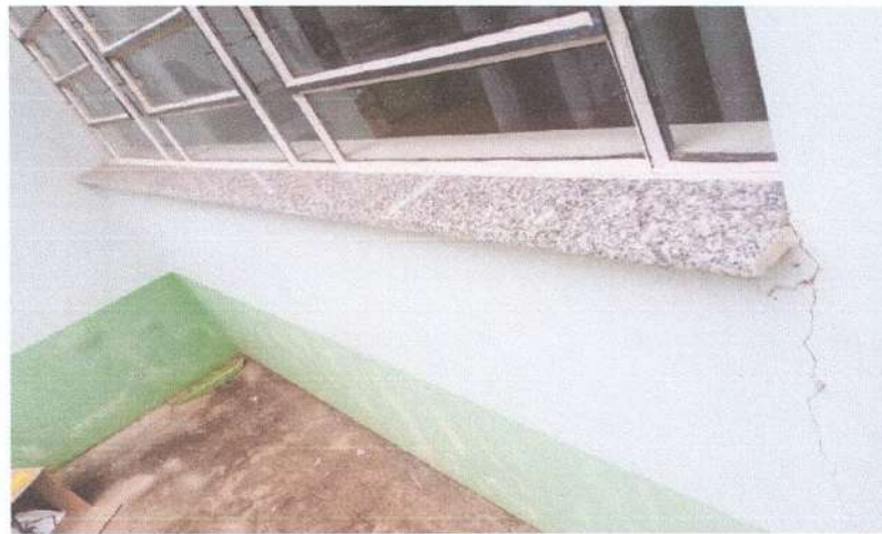
Figura 9: Parede Externa Fissurada
