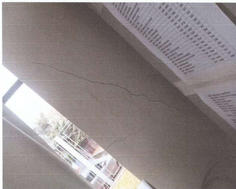
Figura 11: Parede Interna Fissurada
