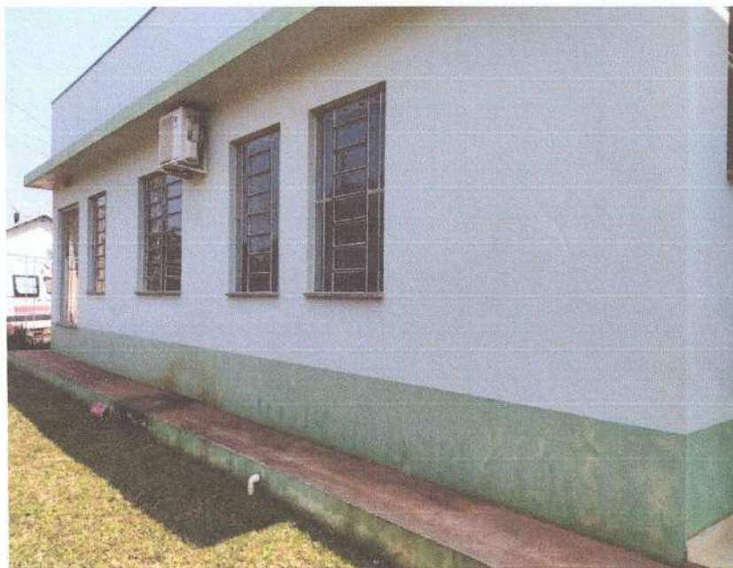
Figura 12: Parede Externa com Pintura Deteriorada
