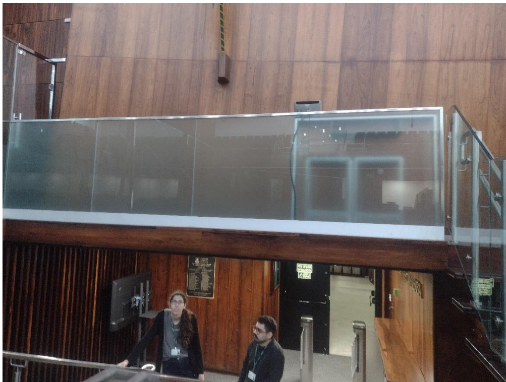
Fotografia: corrimãos instalados no Plenário, em duas alturas, de acordo com as especificações e normas.
