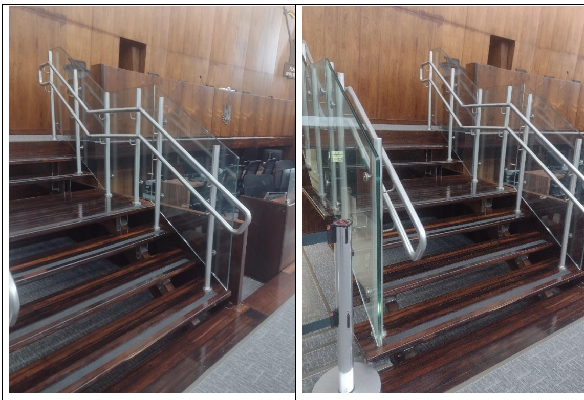
Fotografia: Modelo corrimãos instalados no Plenário, em duas alturas, de acordo com as especificações e normas.
