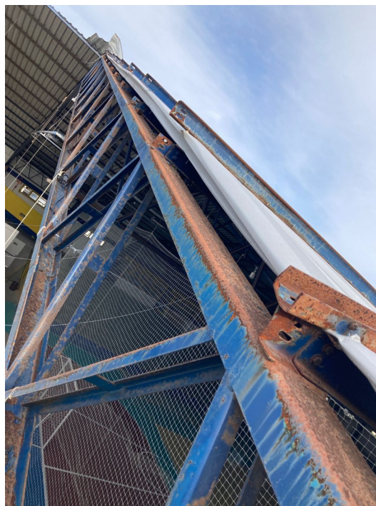
Figura 2: Condições atuais da estrutura
