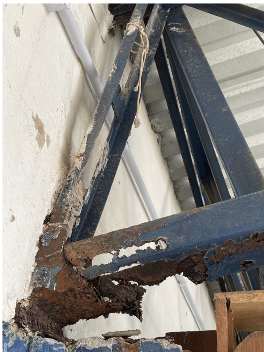
Figura 3: Ponto de apoio de uma das tesouras comprometido
