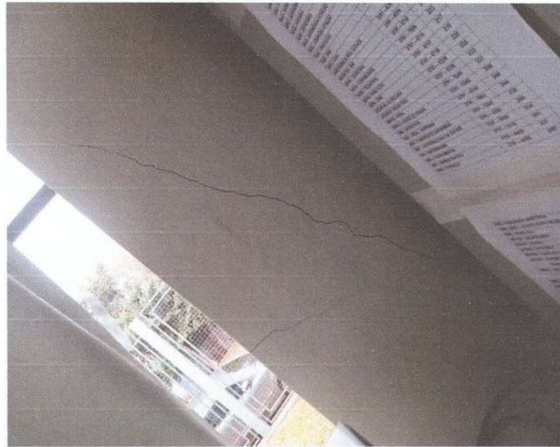
Figura 11: Parede Interna Fissurada
