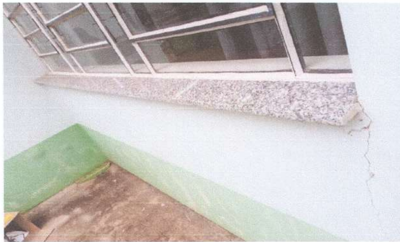
Figura 9: Parede Externa Fissurada
