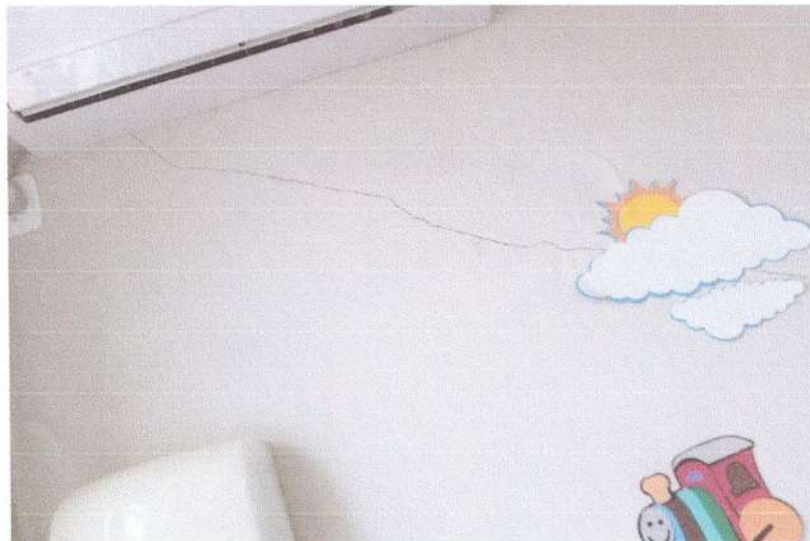
Figura 10: Parede Interna Fissurada
