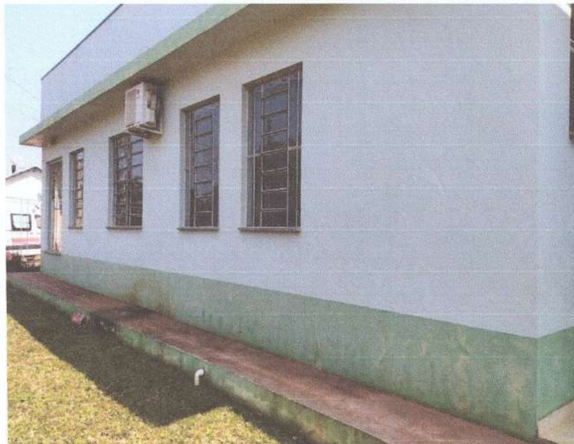
Figura 12: Parede Externa com Pintura Deteriorada
