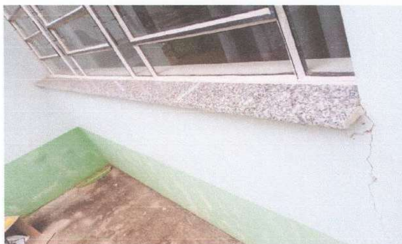
Figura 9: Parede Externa Fissurada
