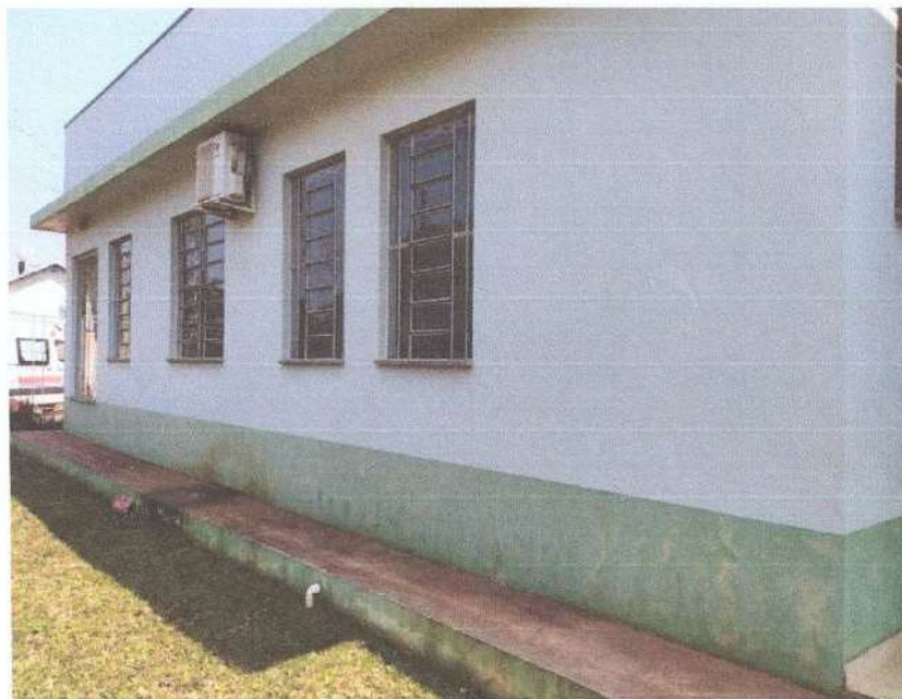
Figura 12: Parede Externa com Pintura Deteriorada
