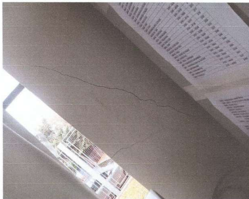
Figura 11: Parede Interna Fissurada
