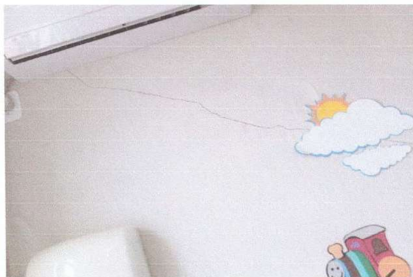
Figura 10: Parede Interna Fissurada
