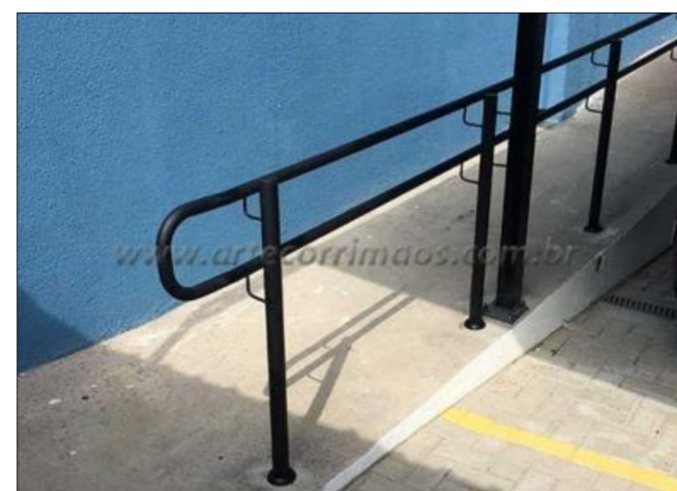
REFERÊNCIA DE CORRIMÃO E GUARDA-CORPO NO SMART LAB E NA RAMPA E ESCADA DO HALL
