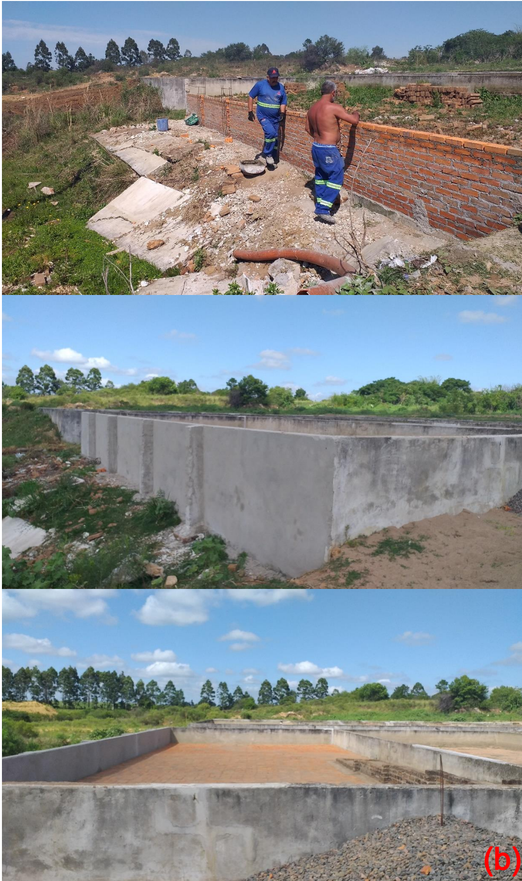
Figura 1 – Muro tombado por erosão do solo (a) antes (b) depois
