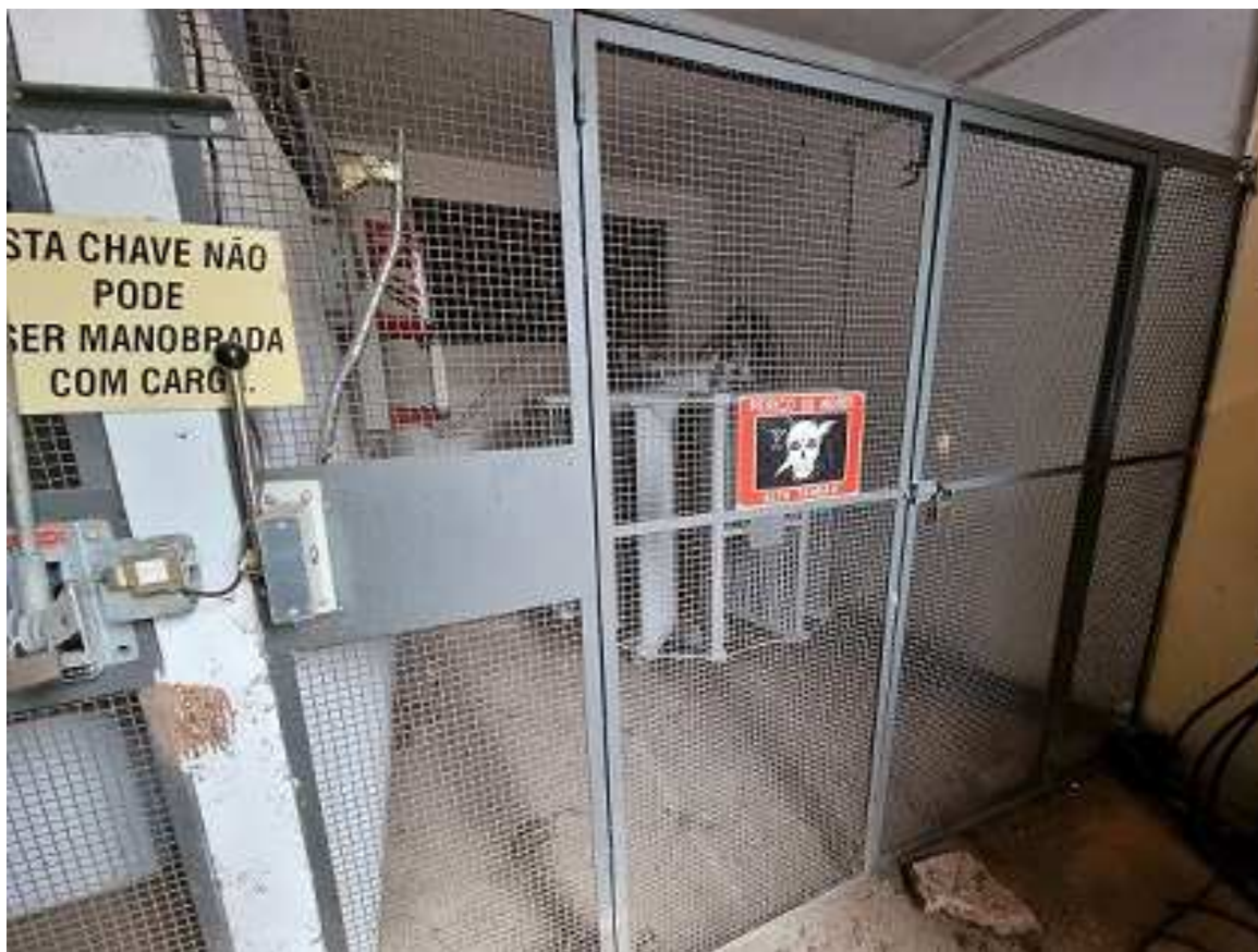
Fig. 5 – Subestação Existente – Transformador 750 kVA a ser removido e colocado a disposição da CORSAN
