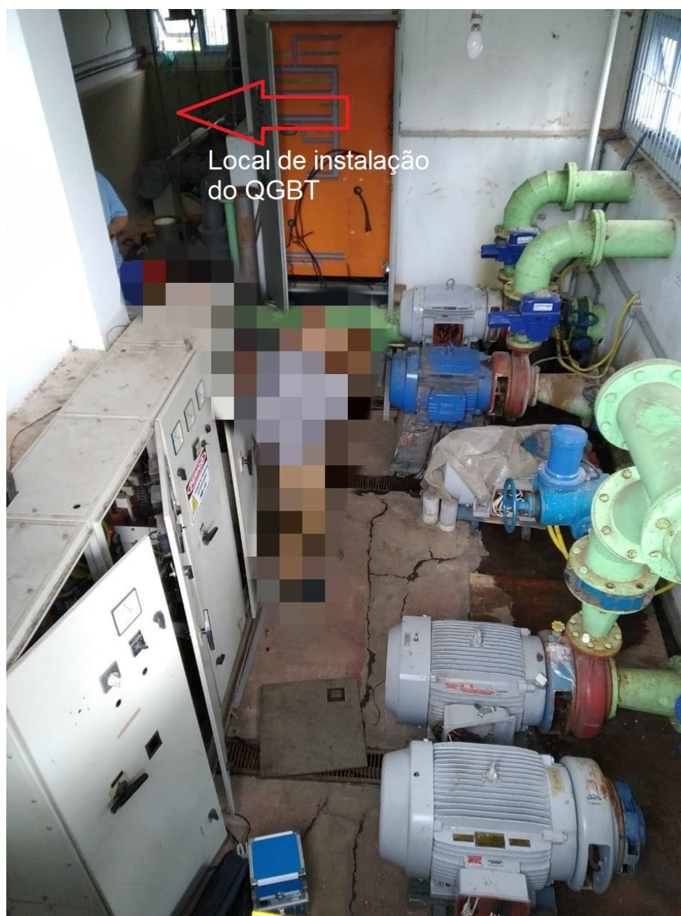
Figura 1: Indicação do local de instalação do QGBT.
