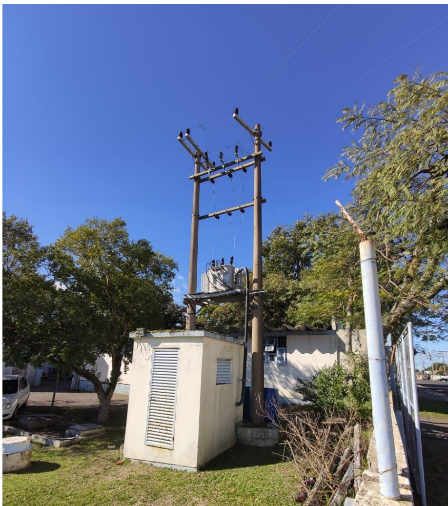
Figura 4: Subestação existente de 150 kVA a ser desativada.
