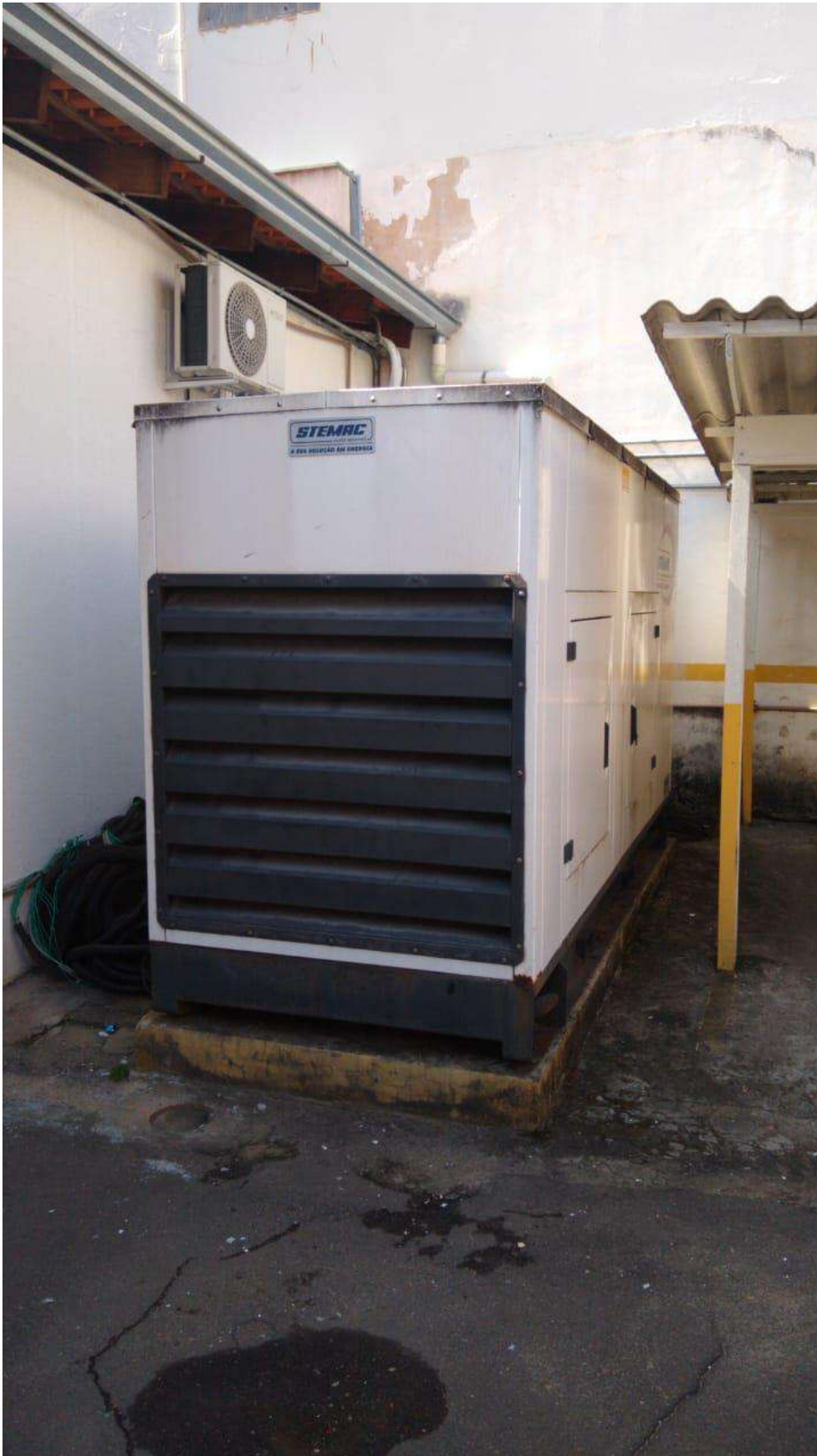
GERADOR STEMAC 180KVA
